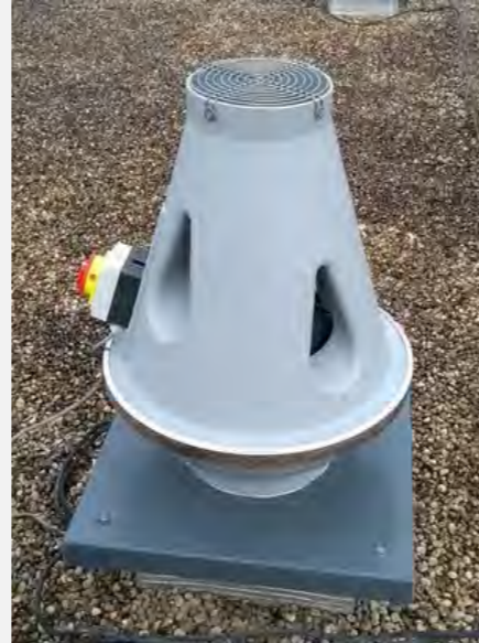
Tourelle d'extraction en toiture
