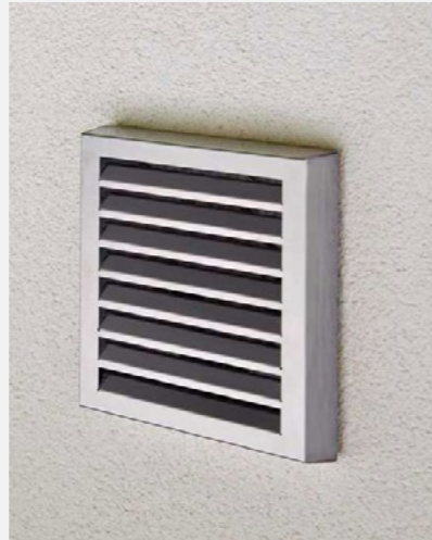
Rejet en façade
