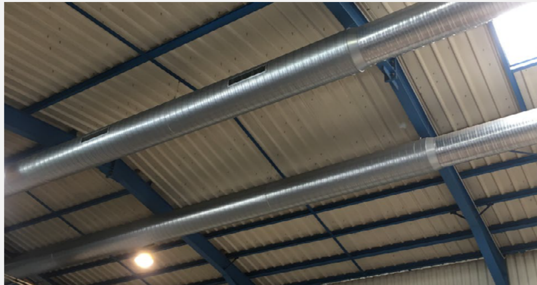
Gaine d'extraction générale
